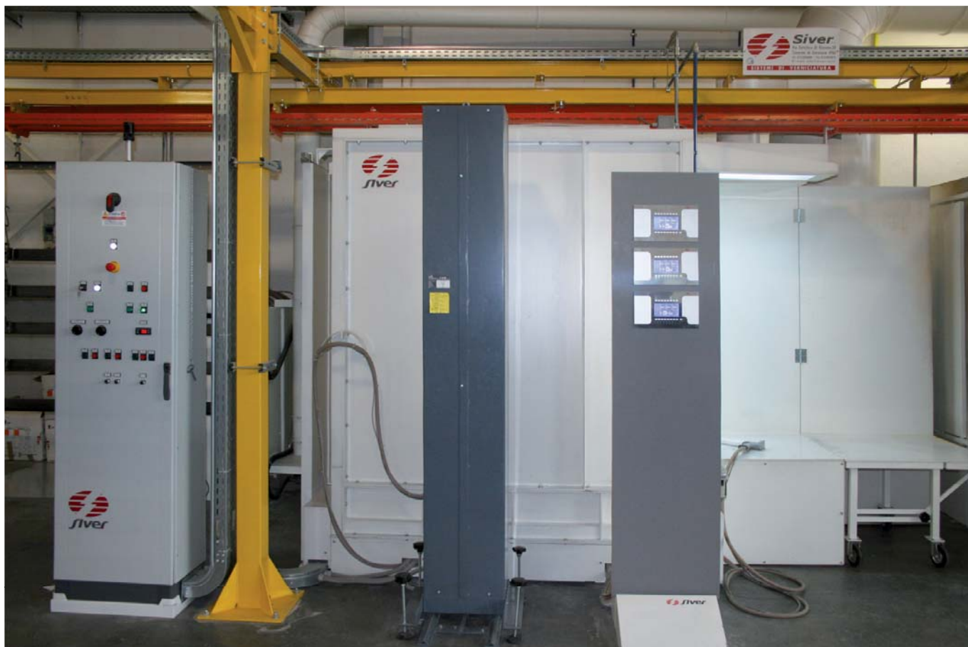
4 – Vista generale della moderna cabina a polveri, Compact, della Siver. Vue générale de la cabine moderne d'application des poudres, Compact, de fabrication Siver.
